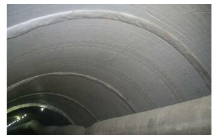
重ね合せ溶着後の防水シートの弛み状況
